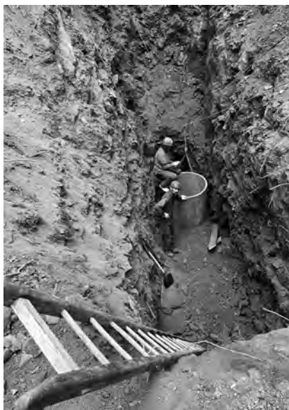
Instalace skruží nad novou šachtou jeskyňářskou skupinou Topas dne 30. 9. 2023 (foto: S. Audyová)
